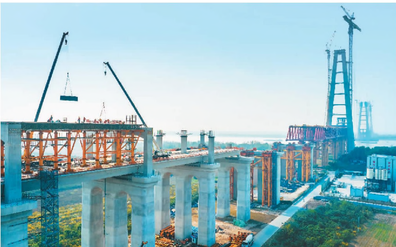
安徽巢湖至马鞍山长江公铁大桥是世界上首座双主跨超千米的三塔斜拉桥,也是世界上最长的联拱钢梁斜拉桥。目前,工程建设正在有序推进。
