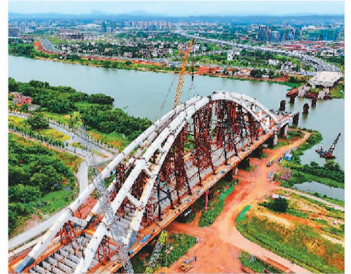
正在建设中的江西省赣州市创业大桥, 是横跨章江的一座特大桥, 大桥建成后有助于连接赣州章江南北组团和高铁、机场片区, 提升城市空间转换效率。图为7月5日, 创业大桥钢结构拱架施工现场。 朱海鹏摄(人民视觉)
