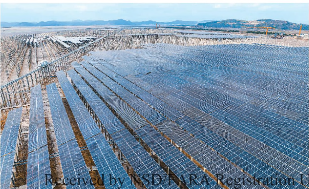
2月5日,浙江省温岭市南海涂渔光互补光伏电站项目一期工程正式并网发电,后续还将建设二期、三期工程。工程全部完工后,该光伏电站年发电量预计达7亿千瓦时。图为项目现场。徐伟杰摄(人民视觉)
