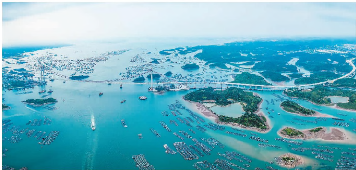
广西壮族自治区钦州市龙门大桥是广西首座千米级跨海悬索桥,项目路线全长7.637公里,其中桥梁总长6597米。大桥建成通车后,防城港与钦州港的行车时间将由原来的1.5小时缩短至25分钟左右。图为4月17日,正在建设中的龙门大桥。何华文摄(人民视觉)
